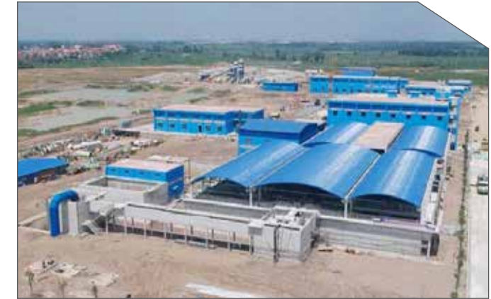
Dự án nhà máy nước mặt sông Đuống Duong river surface water plant project 阳江地表水厂项目
