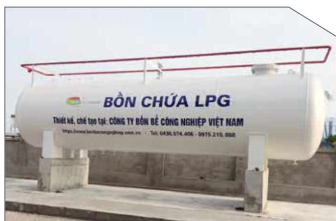
Trạm LPG - Nhà máy FUJI Nhật Bản LPG Station - FUJI Japan Factory 液化石油气站 - 富士日本工厂
